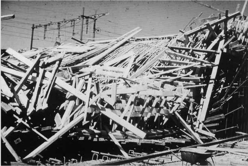
Figuur 1.3 Toelaatbare sterkte overschreden, bezwiken betonbekisting
