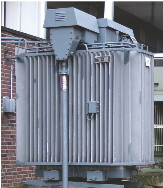
Figuur 13 Nettransformator (Bron: wikimedia.commons.org / Franciscus)
