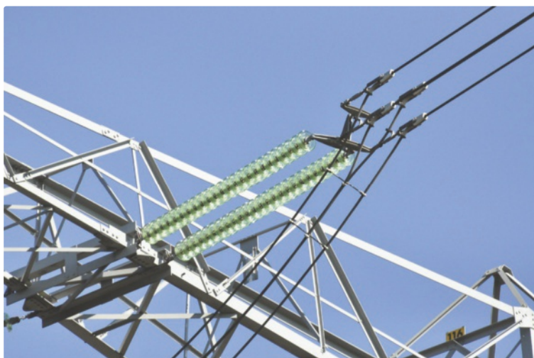
Figuur 11 Hoogspanningsisolatoren van glas (Bron: hoogspanningsnet.com)
