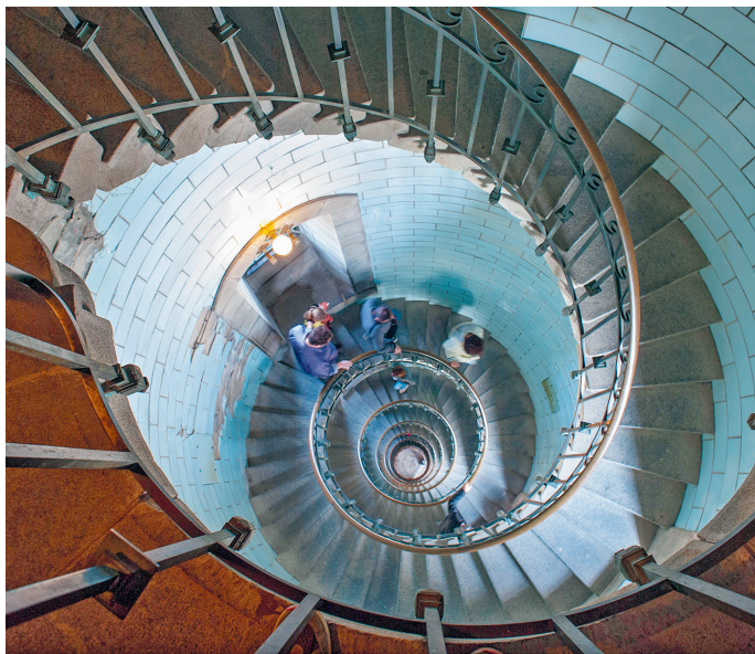
Omhoog in een slaktempo: kijkje in het bijzondere trappenhuis van de Phare d'Eckmühl
