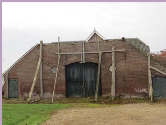
Voorbeeld achterstallig onderhoud.
