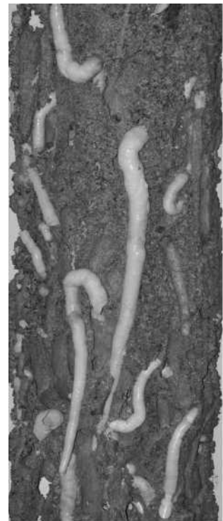
Door paalwormen aangetast hout.
