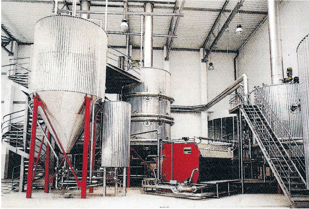
De brouwerij-installatie in de jaren negentig.
