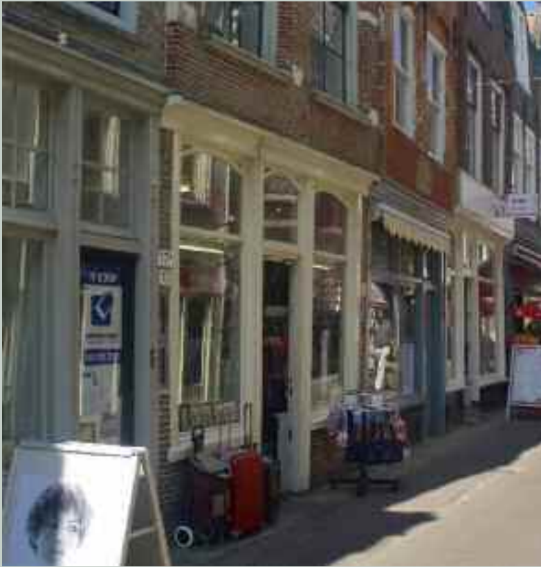
31 Dordrecht, Grote Spuistraat. Huizenrij met verschillende houten winkelpuien die zijn geconstrueerd onder oudere puibalken. Foto auteur.
