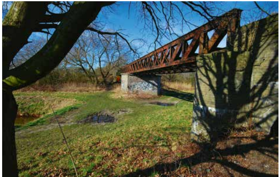
De spoorbrug over de Bossche Sloot bij Vlijmen, ook wel bekend als Venkantbrug, nog voor de restauratie; 10 februari 2008.
