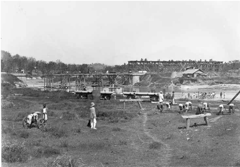
Een grote spoorbrug over de Toentang Rivier in de buurt van Kedoeng Djati in de NIS-lijn Semarang-Vorstenlanden in aanbouw. De ijzeren liggers van de brug zullen straks over de steigers in de rivier getrokken worden, een hele operatie waar veel mankracht voor nodig was. Foto van 1868.
