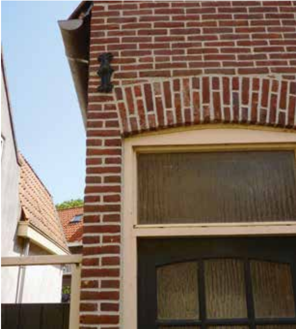
17 Bij Breedstraat 155 in Enkhuizen steekt een ontlastingsboog bij de hoek in de steense zijgevel. (WFW)
