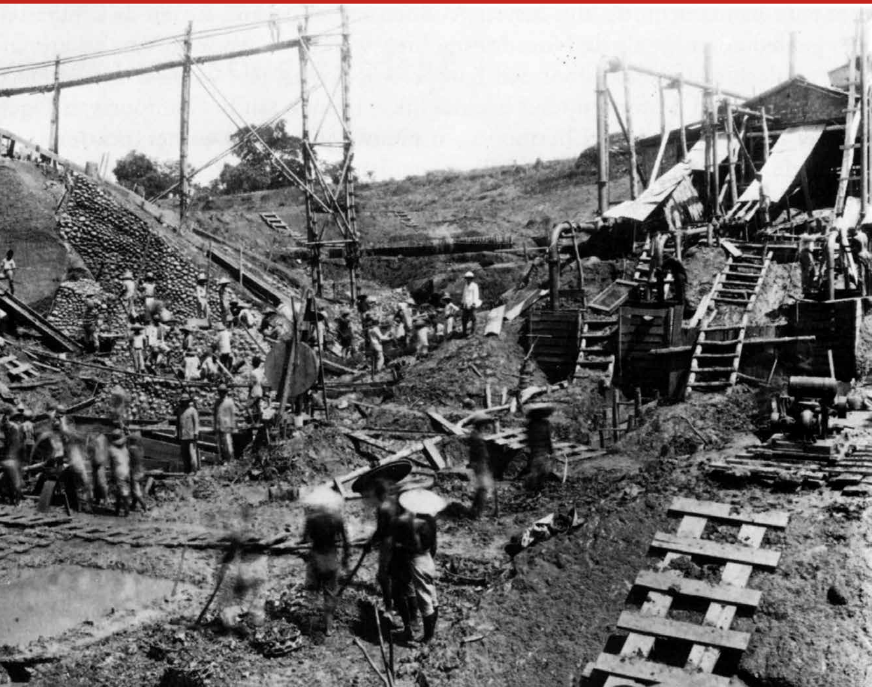
Werk aan de Salam Darma-dam onder leiding van Van Tijen, Java, ca.1925 (privécollectie W. Deeleman-van Tijen).
