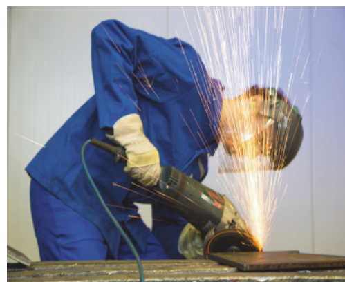
F150: Vonken bij slijpen kunnen brand of explosie veroorzaken.
