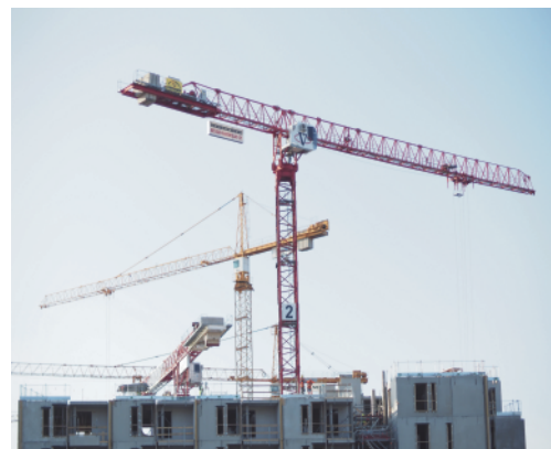
F167: Bij meerdere kranen op een bouwplaats moet er goede afstemming zijn.
