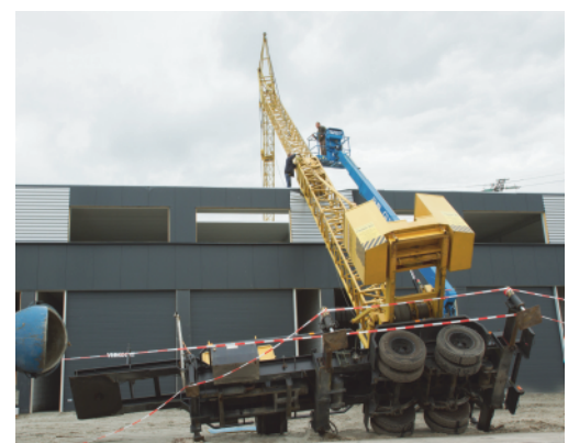
F166: Een gevaar is het omvallen van het hijswerktuig.
