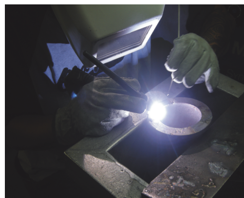
F18: Een vergunning om te lassen wordt ook wel een heetwerkvergunning genoemd.
