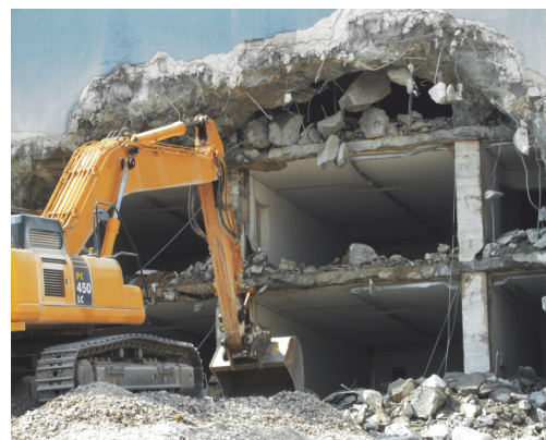
F17: Voor sloopwerkzaamheden is een werkvergunning noodzakelijk.
