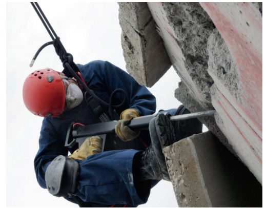
F48 : Bij het gebruik van pneumatische boorhamers ontstaan hand- en armtrillingen.
